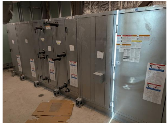
0013-000017e 1/30/2025 Indoor air handler AHU-430 Room M430
