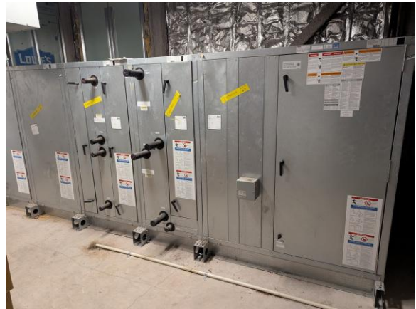
0013-000025e 1/30/2025 Indoor air handler AHU-M222 Room M222
