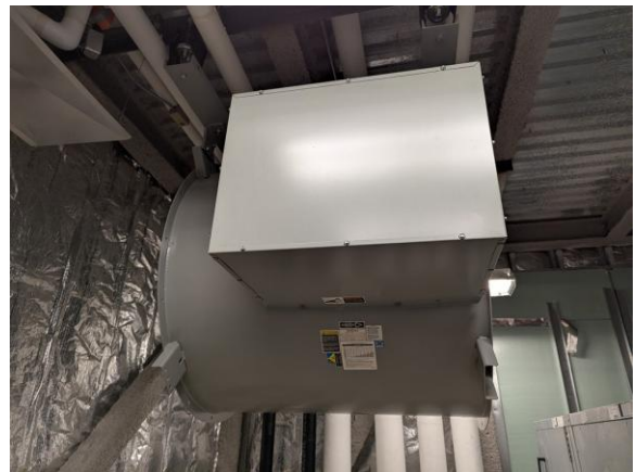
0013-000018e 1/30/2025 Axial flow return air fan RF-430 Room M430
