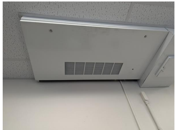
0013-000027e 1/30/2025 Overhead fan coil unit Room 220A
