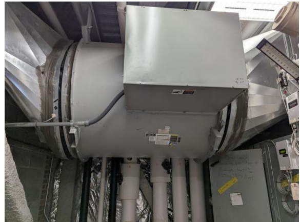
0013-000032e 1/30/2025 Axial flow return air fan RF-1 Room M140
