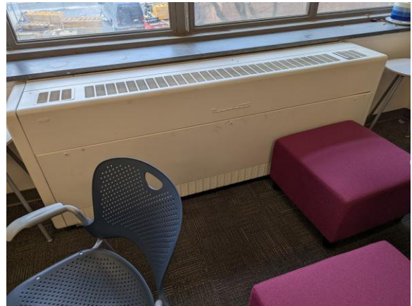
0013-000028e 1/30/2025 Cabinet fan coil unit Room 220A
