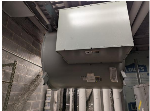
0013-000026e 1/30/2025 Axial flow return air fan RF-M222 Room M222
